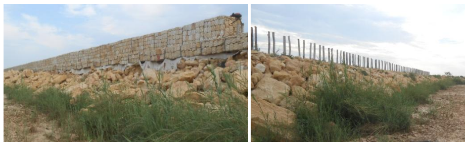
Figure 57. La digue de Fihierenana (intacte à gauche, démantelée à droite) (cliché : Champin, 2016)
