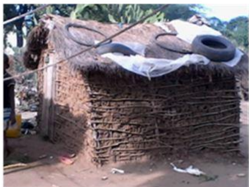
Maison vondro (roseau) ou feta sans plancher et sans réel fondation (4pts)
