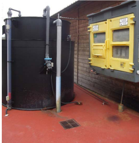
[Figure II.4] Exemple de cuve à chlorure ferrique sur une station de FPR
