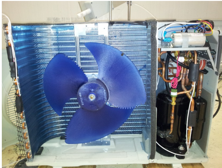
Figure 0-17. Configuration de l'évaporateur et du ventilateur en aspiration d'air avec pose de sondes sur les circuits de l'évaporateur
