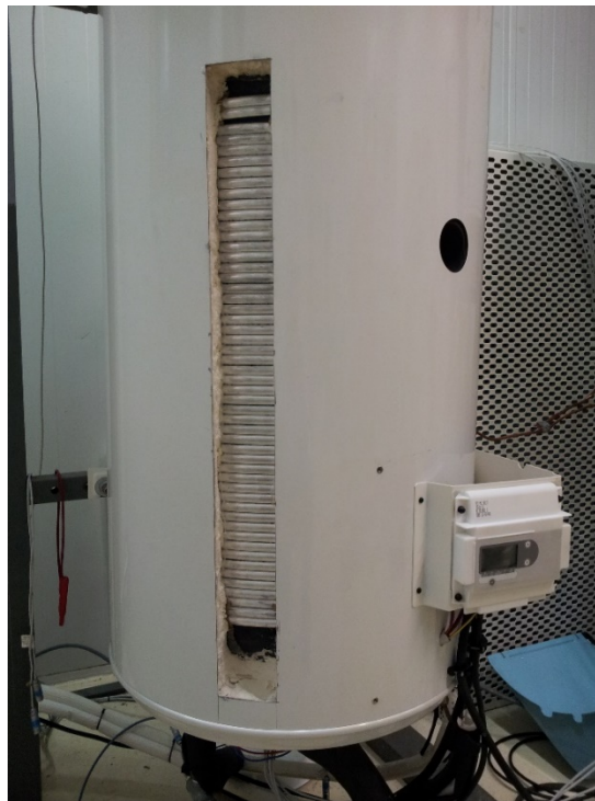
Figure 0-18. Ballon et du condenseur manteau avant pose de sonde
