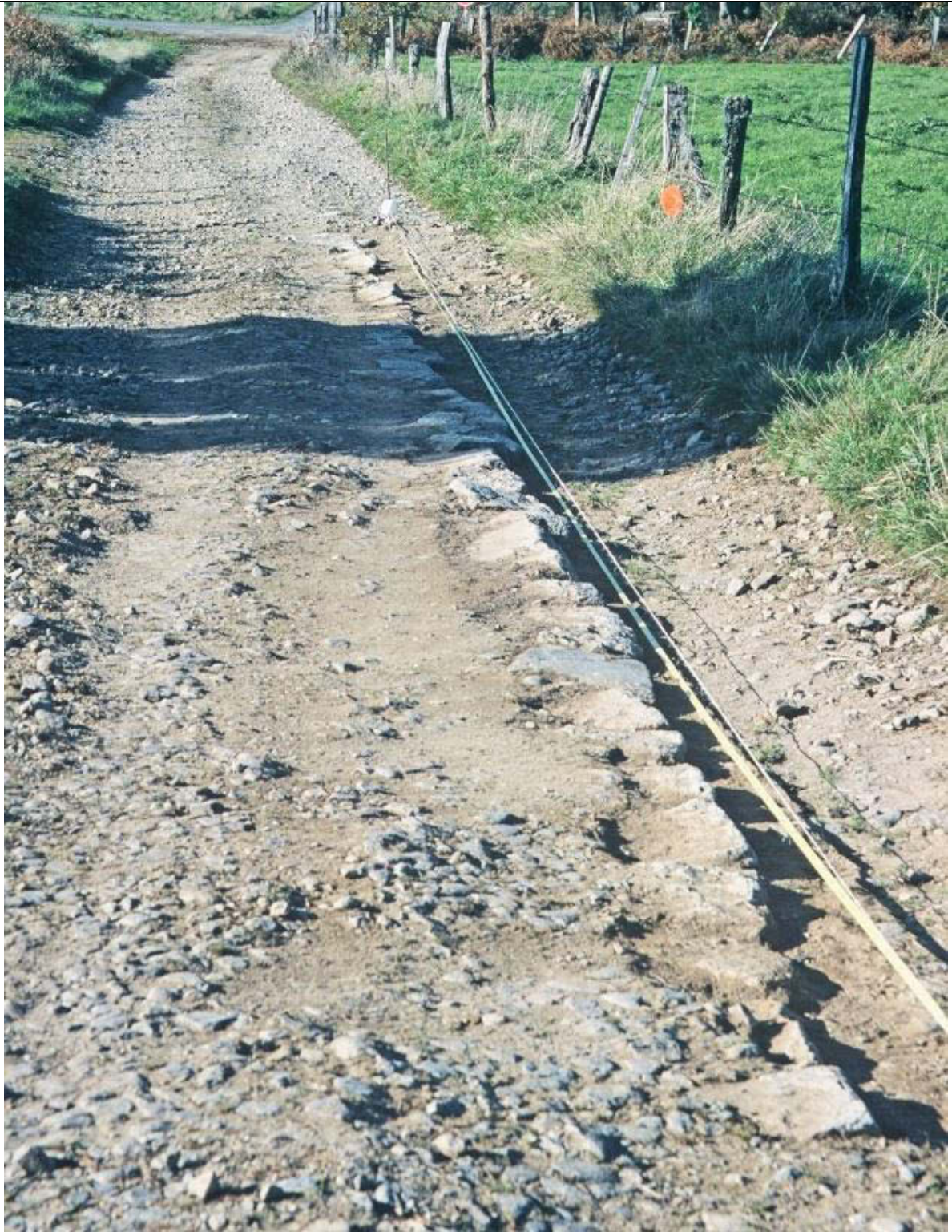
L'utilisation de la voie comme chemin agricole a entrainé l'enfoncement de la chaussée. Les pierres de bordure sont conservées (sur 17 m), mais leur alignement est perturbé (Cliché G. Massounie).
