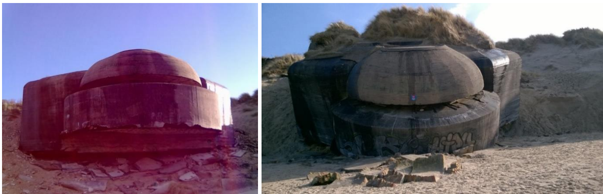
Photographie 3-11. Blockhaus de la plage de Leffrinckoucke – comparatif 2012-2017 suite à la tempête Egon
