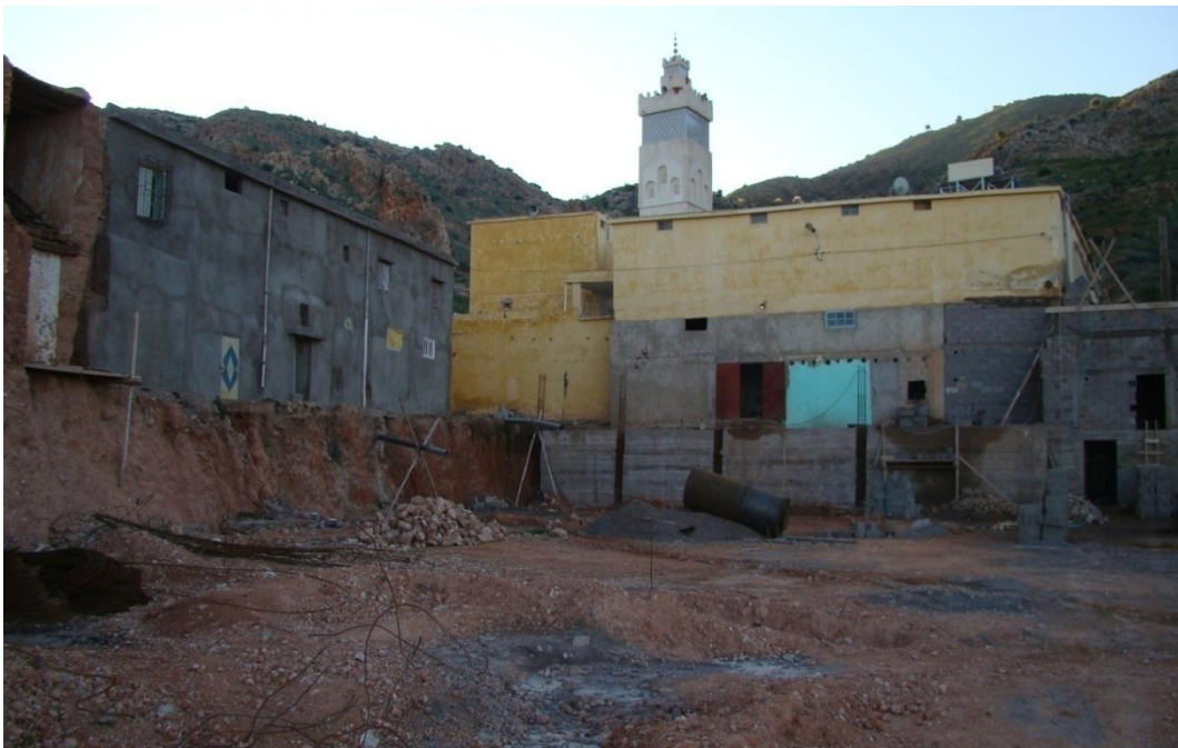
Photo d'une partie des travaux entrepris par le Shaykh actuel à la Zaouïa pour l'agrandissement de l'école traditionnelle ( Al-madrassâ al-'îqâ ) (photo prise par le chercheur)
