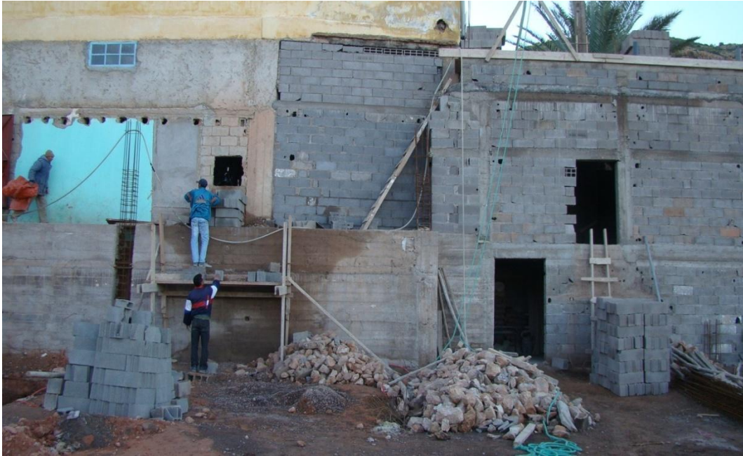
Photo d'une partie des travaux entrepris par le Shaykh actuel à la Zaouïa pour l'agrandissement de l'école traditionnelle ( Al-madrassâ al-'îqâ ) (photo prise par le chercheur)
