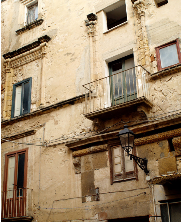
116. État actuel de la façade du palais Nobili, Trapani.
