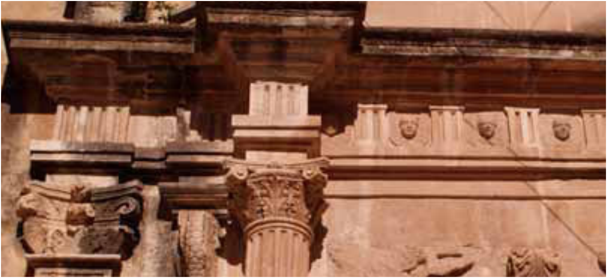
21. Détail de l'entablement de la porte latérale de l'église Santa Maria della Consolazione à Scicli, où les triglyphes s'élargissent au-dessus des piliers latéraux (Cat. XXXII).
