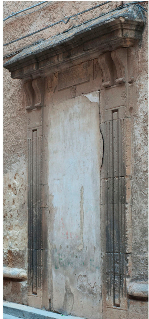
128. Portail lateral de l'église San Pietro à Marsala.
