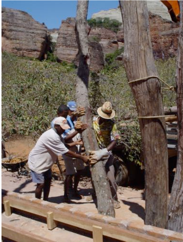
Fig. 160. Travaux de réforme de l'amphithéâtre pour le 1 er Festival en 2003. © Cristiane Bucu, archive Pro-Arte Fumdham.
