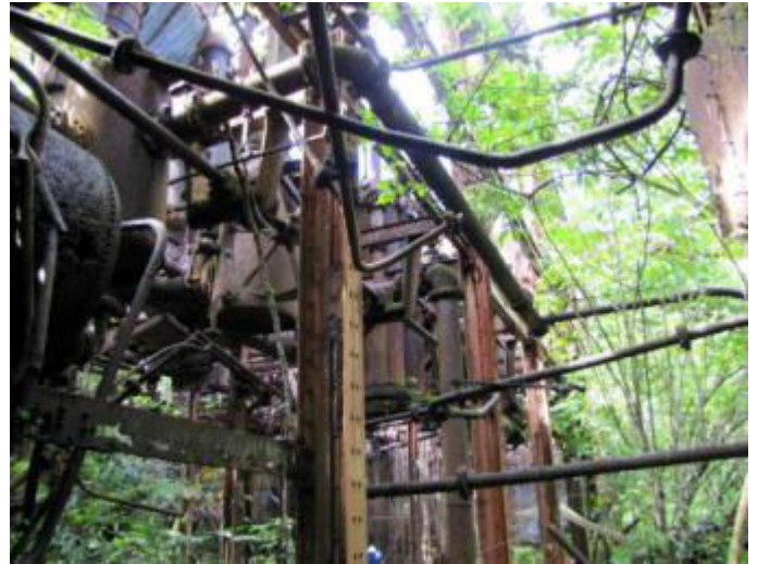
Figure 21 : Les tuyauteries et les cuves
