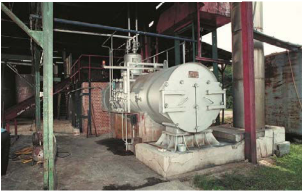
Figure 12 : chaudière à vapeur
