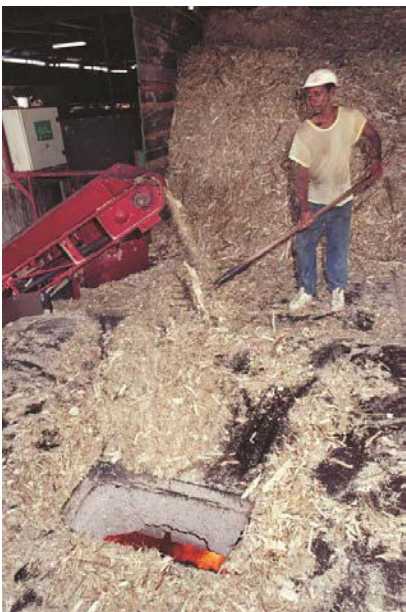
Figure 8 : alimentation des chaudières
