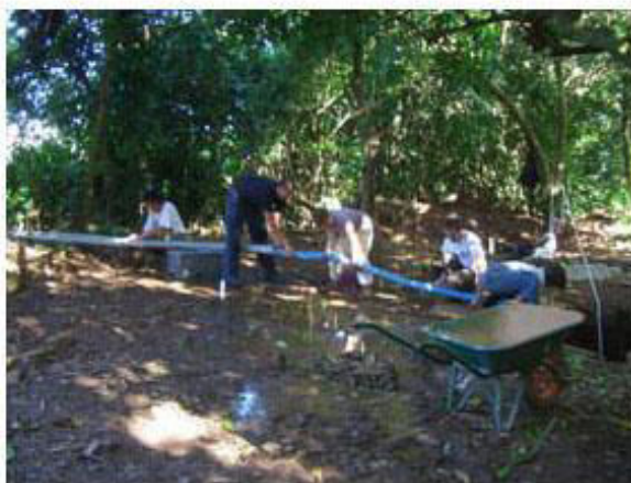
Dispositif de vidange du puits
