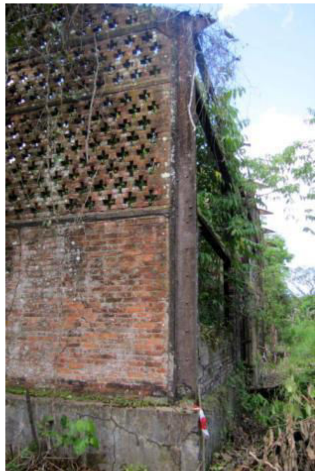
Figure 9 : Angle Nord-Ouest de la sucrerie. Rapport Architecte
