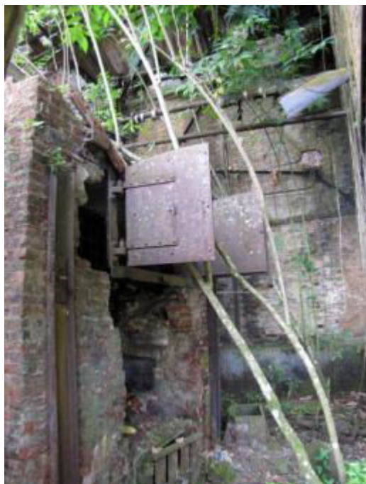
Figure 38 : La chaudière de la distillerie.
