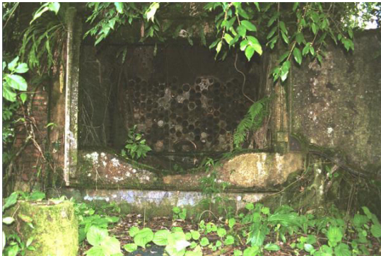
Figure 7 : chaudière dans sa maçonnerie
