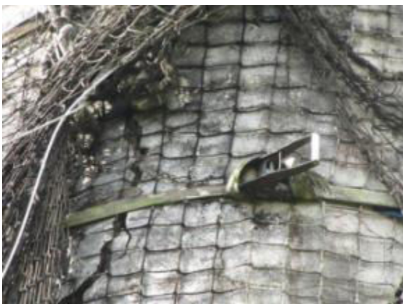
Figure 42 : Sangle et filet de frettage du chemisage fissuré
