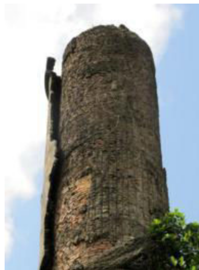
Figure 43 : Chemisage décollé et instable
