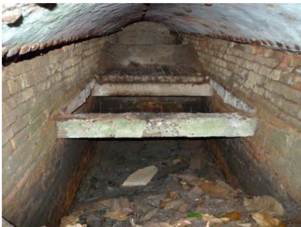
Figure 4 : intérieur de la chaudière
