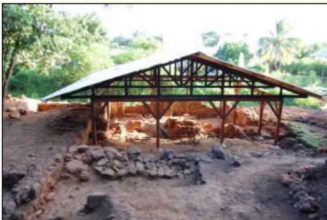
Figure 12 : toit de protection des fours construit par les jeunes de l'association ROZO
