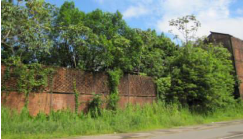
Figure 32 : Les restes du bâtiment central sous la végétation.
