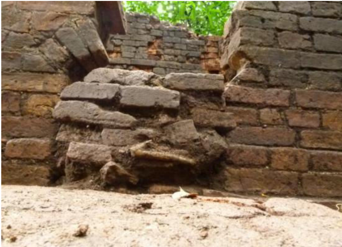
Figure 117 : cendrier de la cheminée bouché
