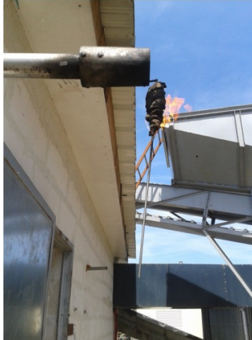
Figure 23 : Torchère de l'unité industrielle
