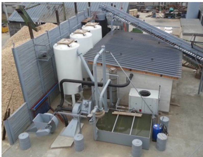
Figure 19 : Photographie d'ensemble de l'unité de cogénération par gazéification d'Enerxyl
