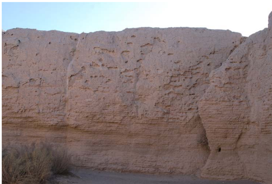
Figure 22 Pan interne sud du site A de D25 (T14) ((c) Arnaud Bertrand : 2015)
