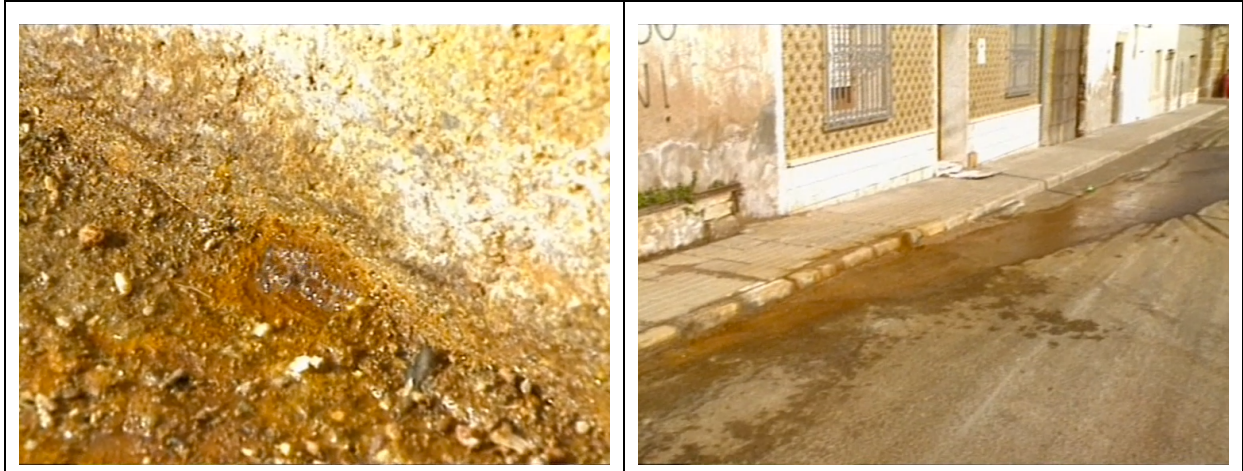
Figure n°19. Portmán, a la sombra de Roberto : Les filtrations dues à la mauvaise imperméabilisation des installations
