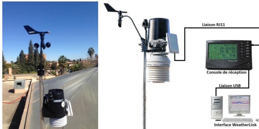
Figure II.6. Station météorologique DAVIS Vantage Pro2 et son branchement
