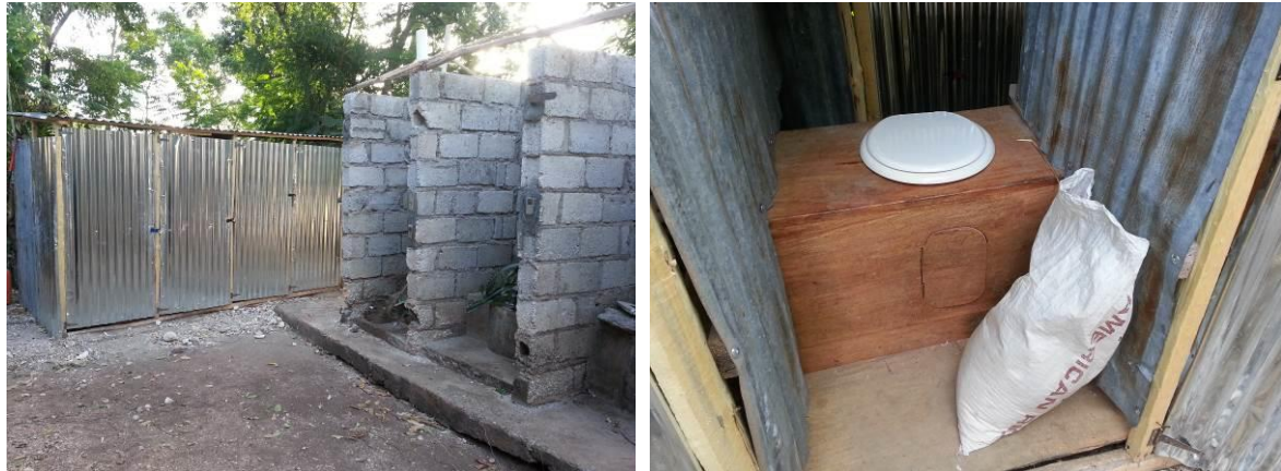
Figure 19 : Bloc de 4 TLB installé dans une école
