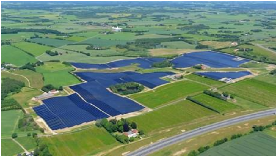
Figure 2-11 : La plus grande installation solaire thermique raccordée à un réseau de chaleur au monde en 2016 : 110 MWth, soit 156 694 m 2 de capteurs solaires. Silkeborg (Danemark) [17].
