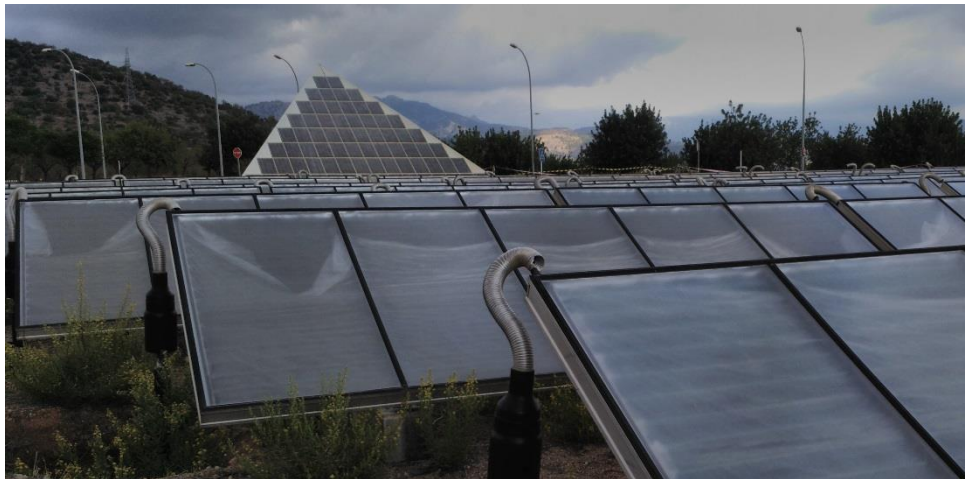
Figure 3-5 : Capteurs solaires dont le film FEP s'est en partie déchiré.
