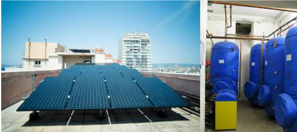
Figure 235 : Photographie de l'installation
