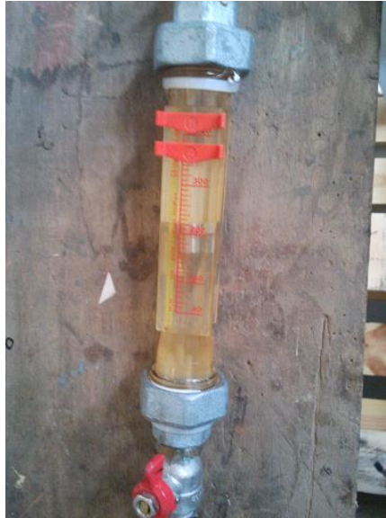
Figure 65 : Photographie du débitmètre à lecture graphique
