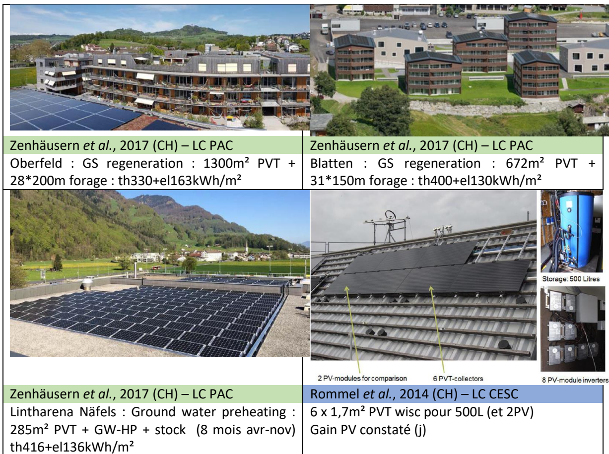
Figure 15 : Installations monitorées pour le segment logements collectifs (LC) en couplage PVT + pompe à chaleur (PAC) et en chauffe-eau solaire collectif (CESC)
