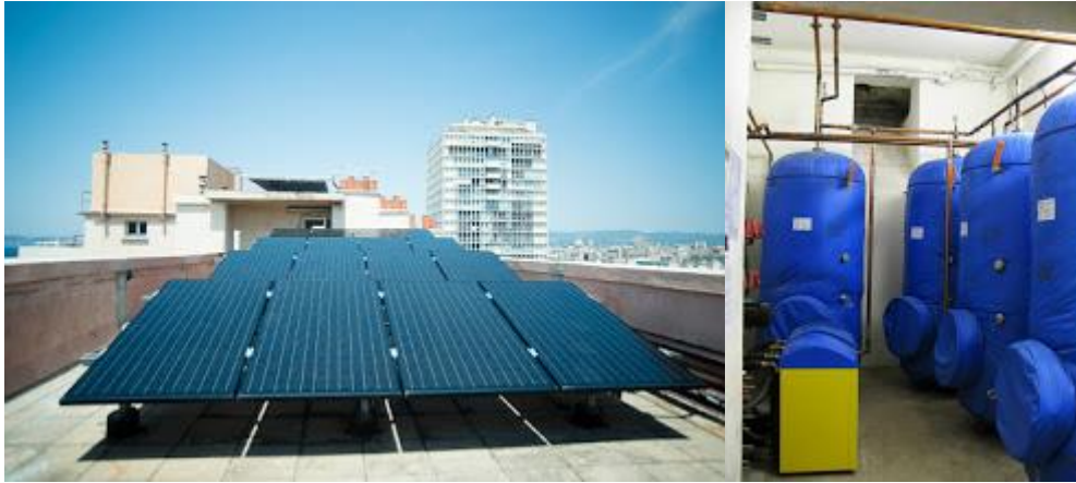
Figure 235 : Photographie de l'installation
