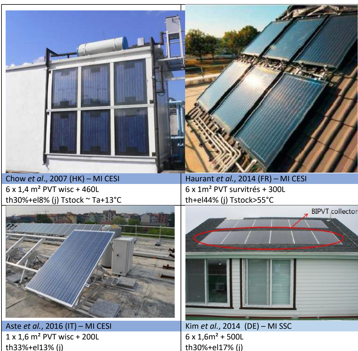
Figure 13 : Installations monitorées pour le segment maisons individuelles (MI) en chauffe-eau solaire individuel (CESI) et système solaire combiné (SSC)
