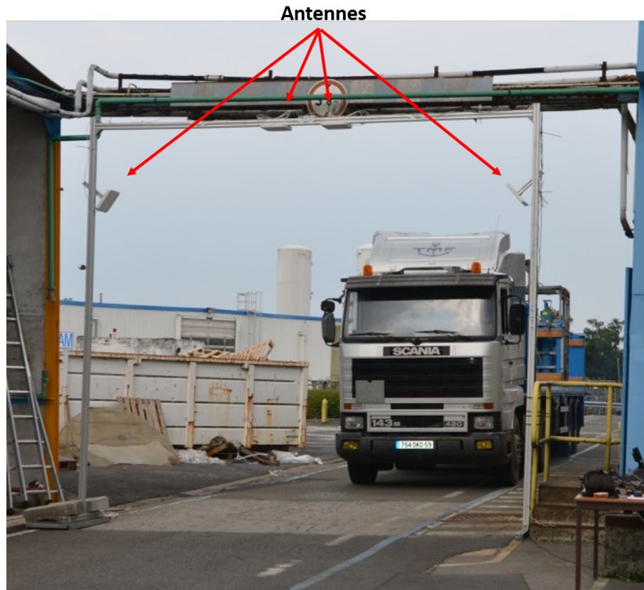
Figure 1.4 – Passage d'un camion chargé sous un portique RFID UHF
