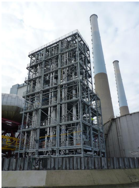
Figure 4 : Pilote de Captage du CO 2 en post-combustion du Havre
