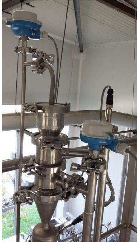
Figure 43 : Le système de récupération des dépôts installé en tête du faisceau F3
