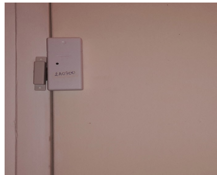
Main Door Sensor
