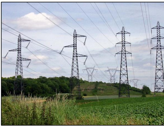
a. Lignes aériennes et pylônes
