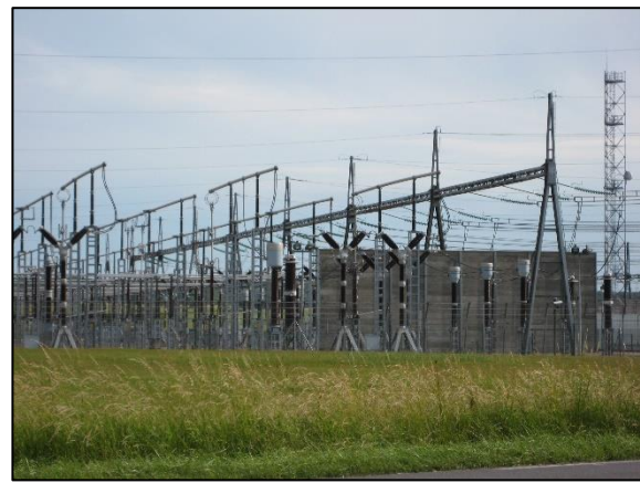
b. Poste de transformation
