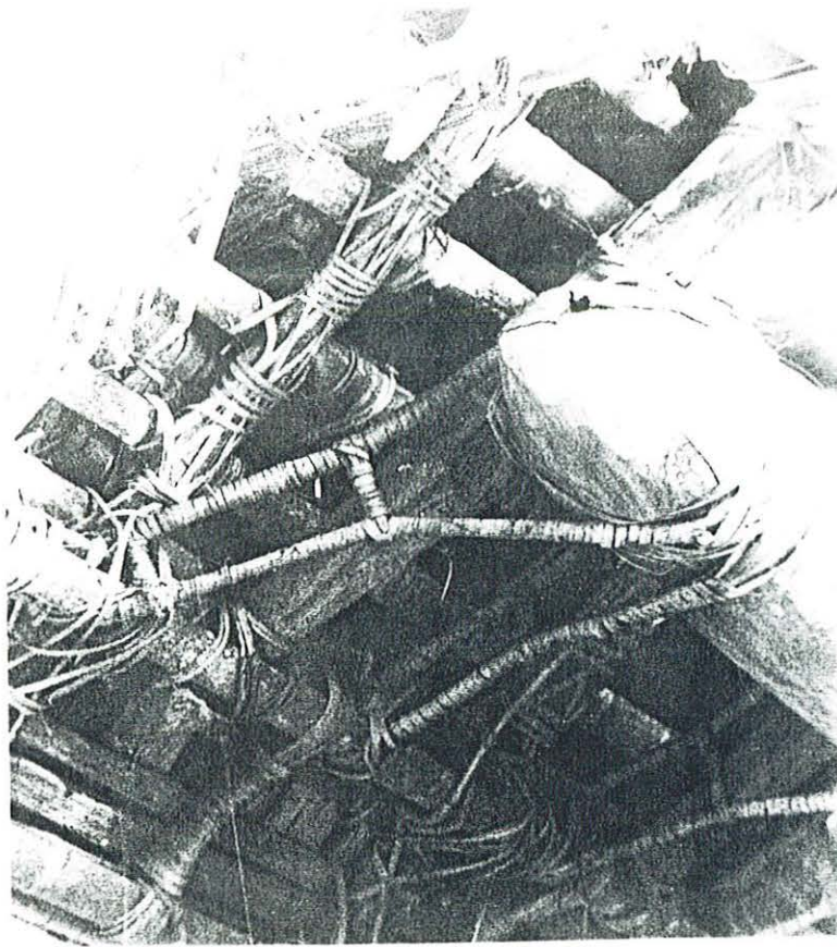
Photo. n°229 - Divers types de ligatures utilisées pour l'assemblage des pièces de charpente des maisons cérémonielles iatmul.
