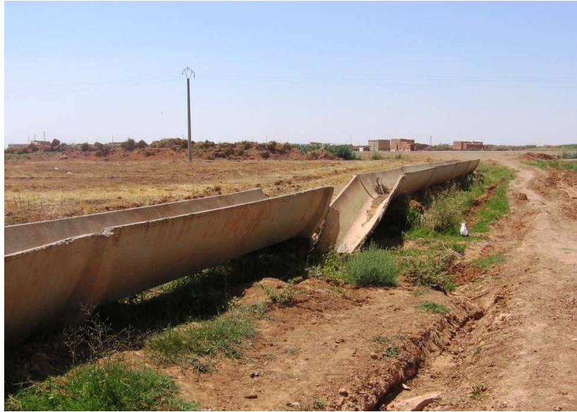
Figure 89 : Un réseau d'irrigation en mauvais état. Cliché : Roman-Oliver Foy, juin 2010
