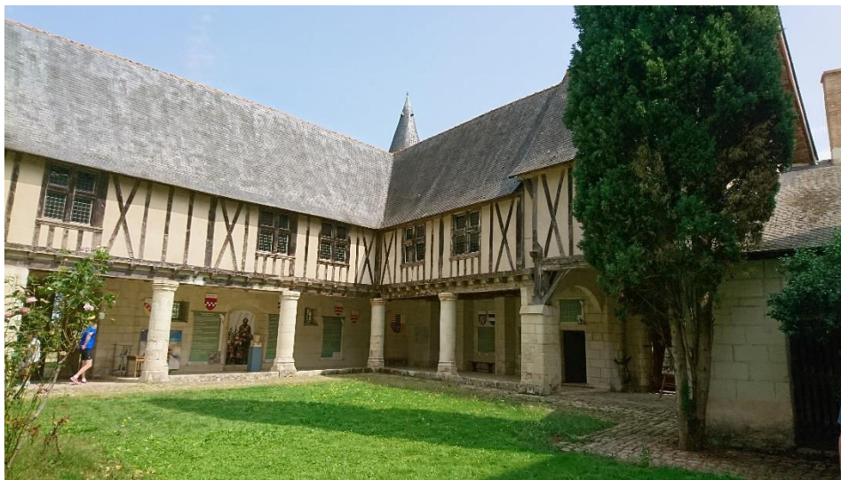
Figure 4 2: Structure en bois du Manoir de Launay, Villebernier, Maine-et-Loire (vue de la cour)
