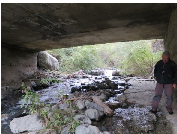
Figure 335 : Passage du torrent de la Vaudaine sous le pont de la RD 1091, vu depuis l'aval (Source : RTM 38, ONF).
