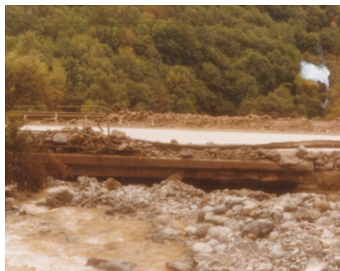
Figure 104 : Pont de la RN91 à l'issue de la lave torrentielle du torrent de la Vaudaine du 10 août 1983 (RTM 38, ONF).
