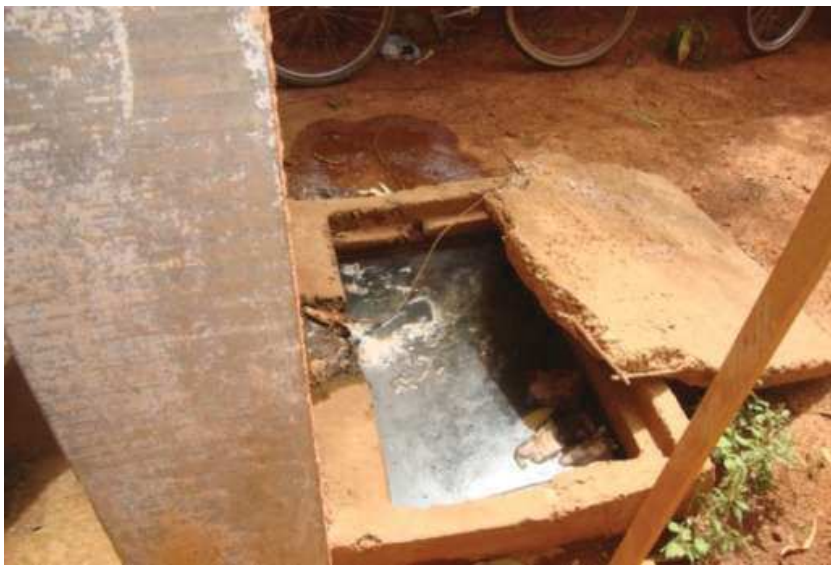
Figure 1. 11 : Eaux usées de la mosquée de l'université déversées dans un canal mal étanchéifié.
