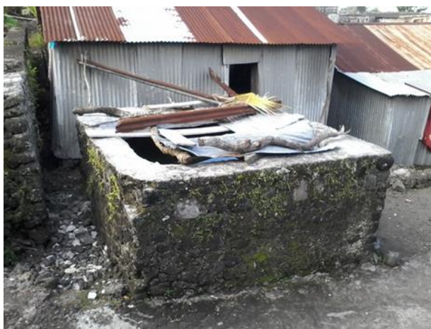
Photographie 26 : Citerne avec gouttière en tôle en dehors du ménage à Hassendje à la Grande Comore
