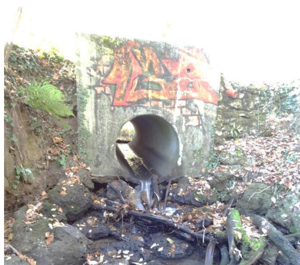
Figure 7.5: Buse implantée transversalement au lit de la Mérantaise (amont), portant des marques d'affouillement et d'incision.
