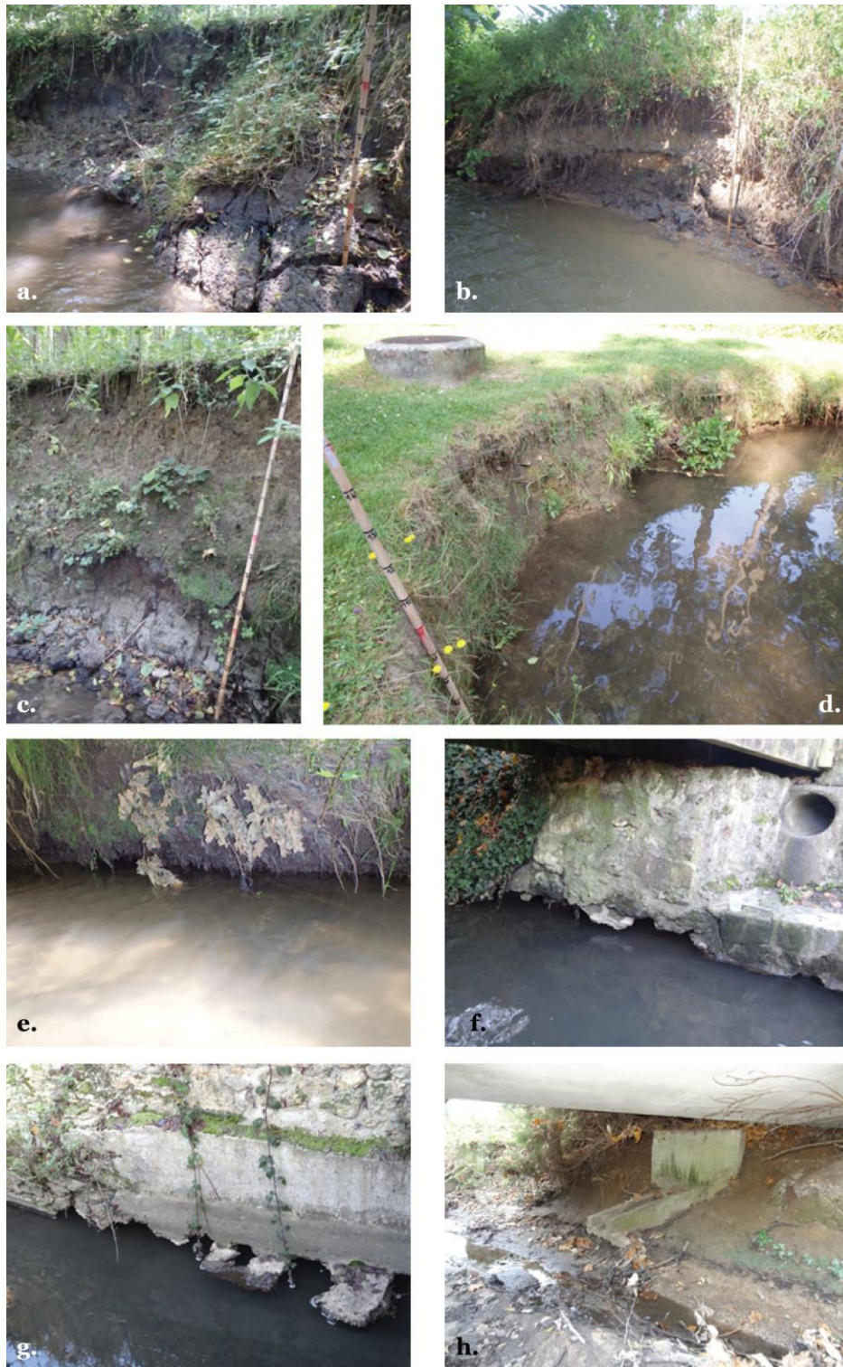
Figure 3.11 : Exemples de traces d'érosion de berge active (a., b.) ou potentielle (c., d.) ; ainsi que d'affouillement de berge (e.) ou d'ouvrages latéraux (f., g., h.). (Crédits photo : M. Jugie)
