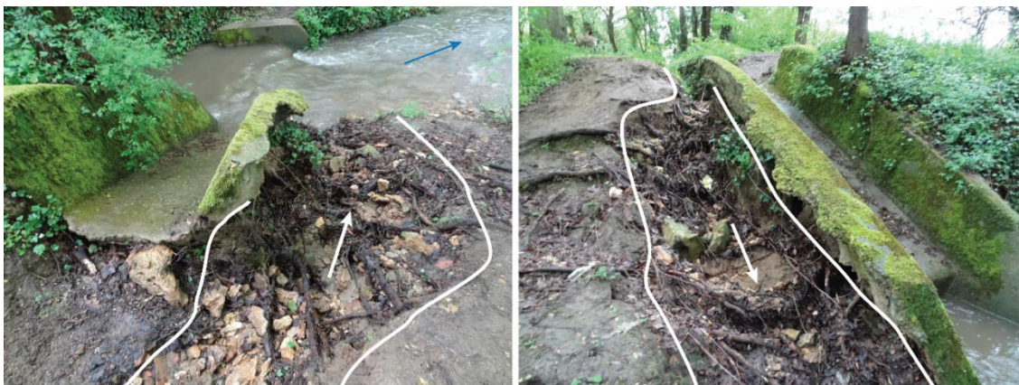
Figure 8.10 : Buse déconnectée des écoulements à cause de l'érosion de la ravine en amont.
