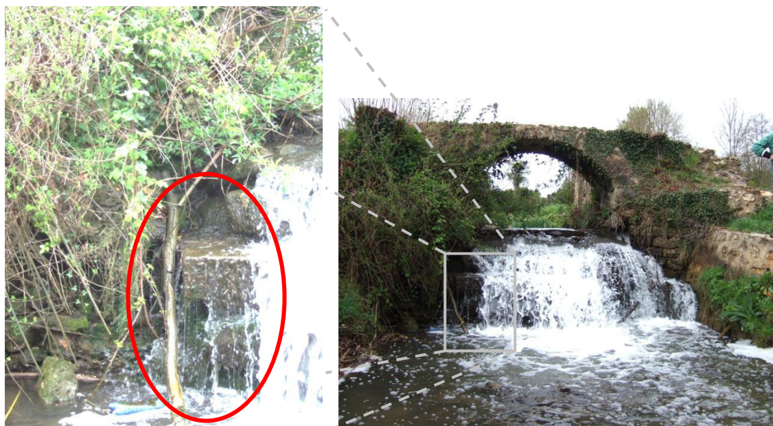
Figure 7.4: Marques d'affouillement des piles du seuil d'Ors
