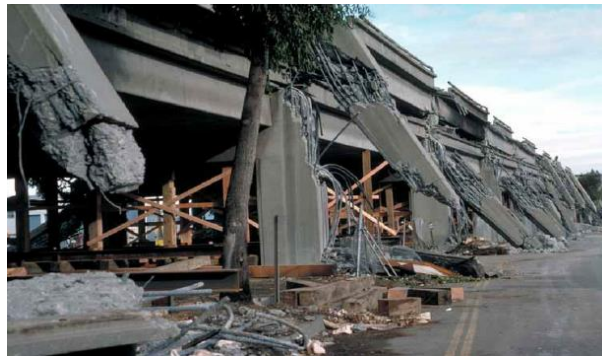
Figure 1-1 Rupture des piliers d'un pont à Kobe au Japon suite à un séisme en 1995
