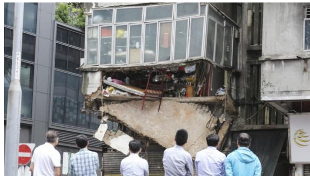
Figure 1-3 Effondrement d'un balcon en cisaillement à Hong Kong en Juin 2017
