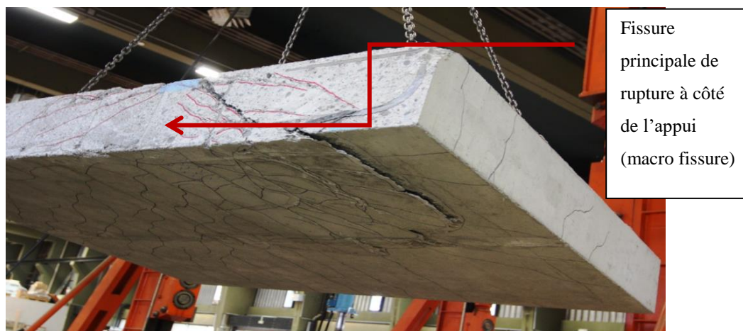
Figure 4-7 Découpage de la dalle S15 : Mode de rupture en 2D et 3D
