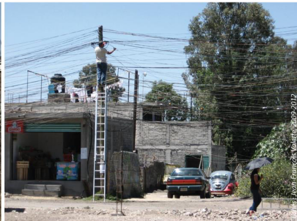
Photo 6.8. Ampliación La Conchita, Tláhuac, DF [2010] Pose et réparation de câbles précaires et privés pour l'alimentation électrique d'une maison du quartier illégal
