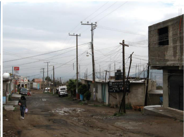
Photo 6.12. Lomas San Sebastián, La Paz, Etat de México [2010] Co-présence des réseaux électriques "pirates" et légaux
