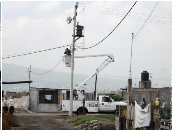
Photo 10.10. Travaux d'électrification à Tempiluli, Tláhuac, DF [2010] Camion de la délégation pour la pose des câbles légaux : frais et matériel partagés entre la municipalité et les résidents
