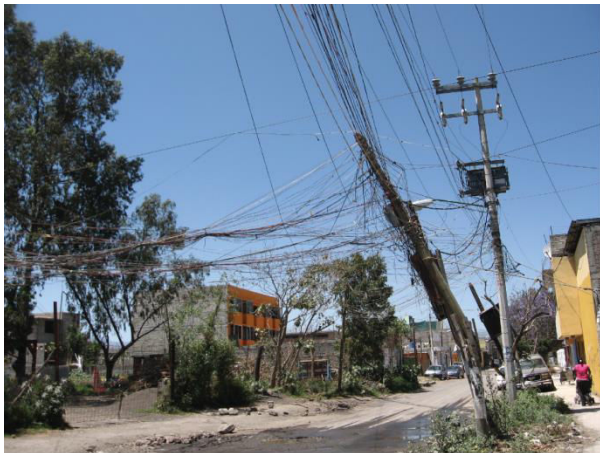
Photo 8.11. Ampliación La Conchita, Tláhuac, DF, 2010. Jeune maman promenant son enfant en poussette dans son quartier. Entre absence de trottoirs, de système d'évacuation des eaux (usées et pluviales), d'enrobé pour la circulation, et de réseau électrique sûr, les réseaux urbains sont particulièrement déficients dans cette colonie en 2010-2011.
