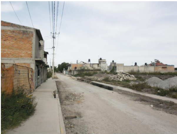
Photo 10.7. Travaux de construction des trottoirs, du réseau d'assainissement et de bitumage de la route à La Trinidad, Cuautitlán, Etat de Mexico [2011]
