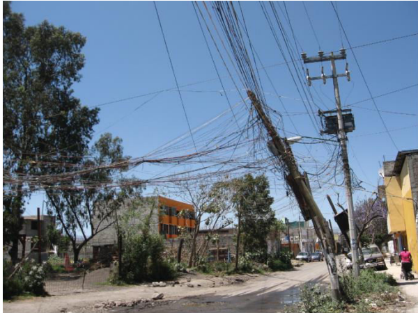
Photo 8.11. Ampliación La Conchita, Tláhuac, DF, 2010. Jeune maman promenant son enfant en poussette dans son quartier. Entre absence de trottoirs, de système d'évacuation des eaux (usées et pluviales), d'enrobé pour la circulation, et de réseau électrique sûr, les réseaux urbains sont particulièrement déficients dans cette colonie en 2010-2011.
