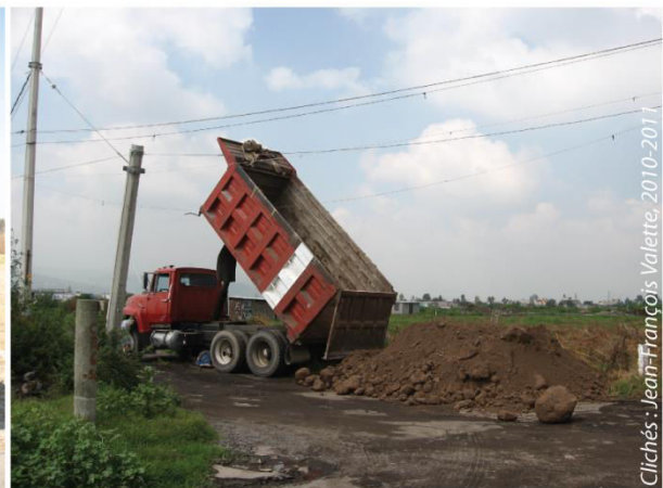
Photo 8.16. Tempiluli, Tláhuac, DF, 2010. Travaux de terrassement et de nivellement d'une rue par apports de gravats et de terre.
