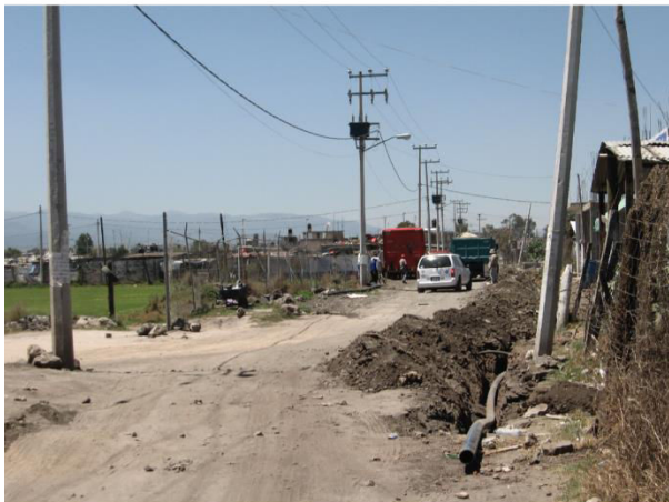
Photo 6.7. Tempiluli, Tláhuac, DF [2010] Pose de l'adduction d'eau, terrassements et électrification dans un quartier illégal
