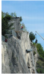
En novembre 2009, une chute de blocs de plusieurs mètres cubes est survenue depuis la falaise de la Bastille. Des grillages ont été posés à cet endroit.
