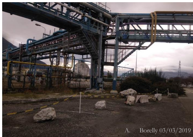
Figure 38 : Pipelines aériens route de l'électrochimie à Jarrie
