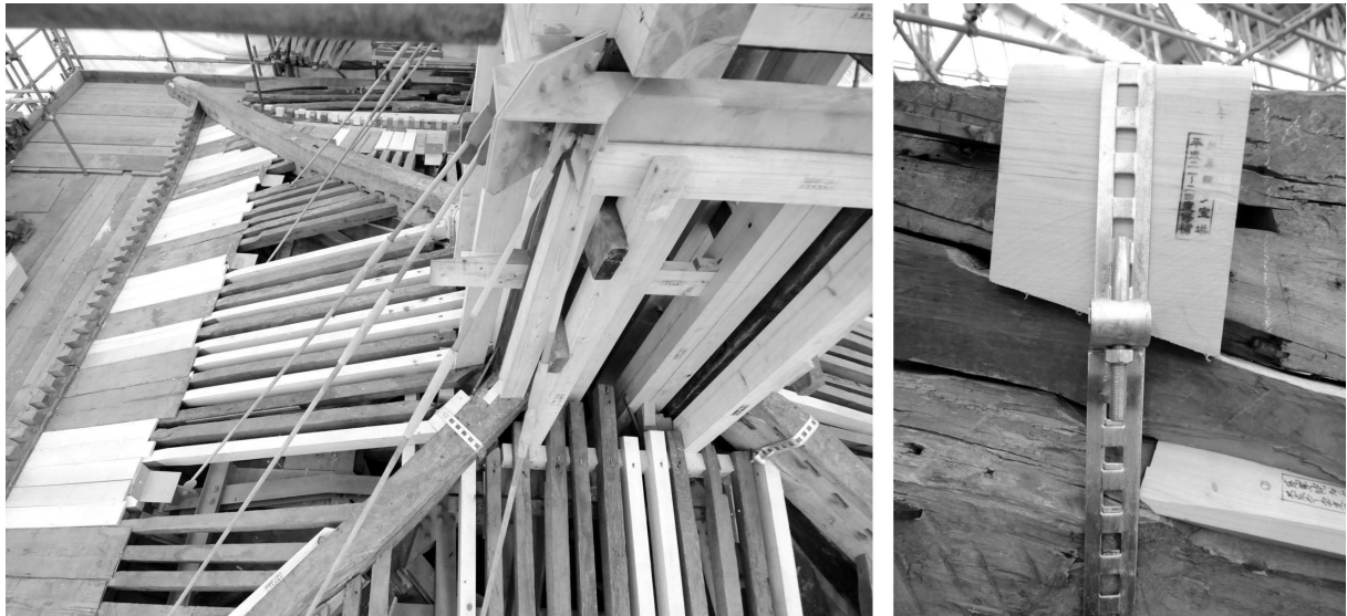
Figure 25 - Deux exemples de renforts métalliques sur le toit (tirants et collier), 2011 (photographies de l'auteur).
