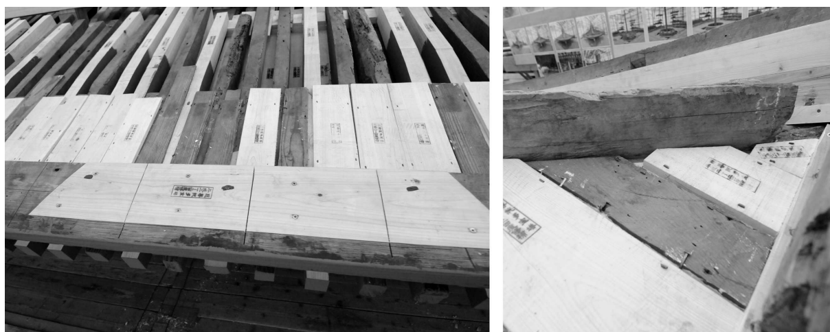
Figure 24 - Pièces de bois neuves insérées au milieu des anciennes (les objets remplacés sont systématiquement marqués au tampon pour les distinguer même après usure et changement de couleur du matériau), 2010 (photographies de l'auteur).
