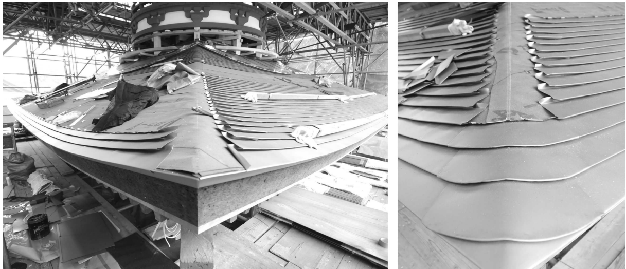
Figure 26 - Lamelles de titane en place sur le toit en fin de pose de couverture, 2011 (photographies de l'auteur).
