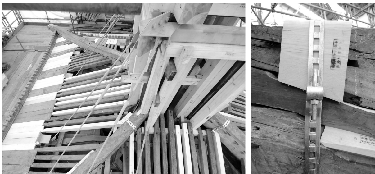
Figure 25 - Deux exemples de renforts métalliques sur le toit (tirants et collier), 2011 (photographies de l'auteur).
