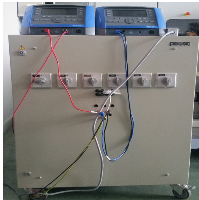
Figure 1.36: Charge résistive variable de 6 kW.
