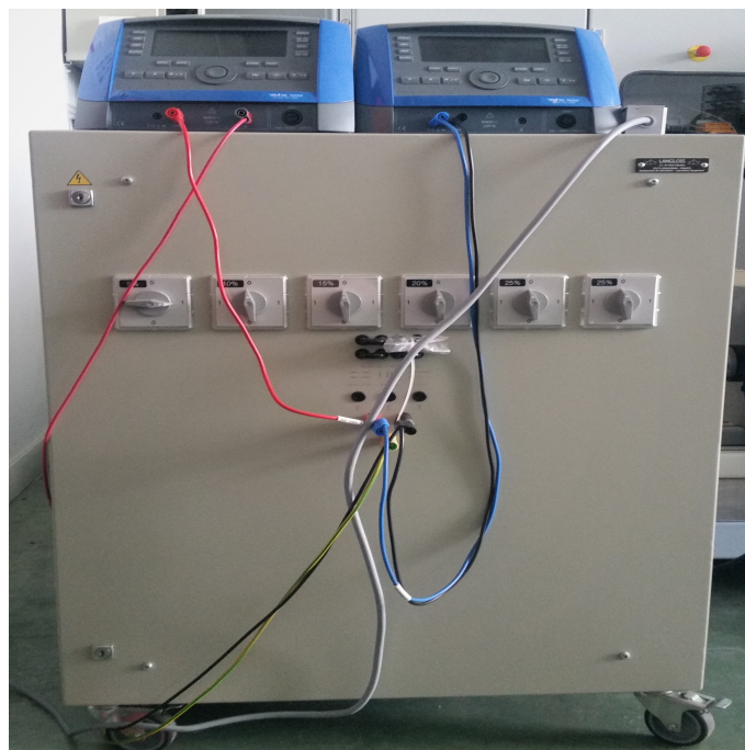
Figure 1.36: Charge résistive variable de 6 kW.
