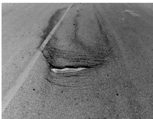
FIGURE 5.25 – Défaut d'interface, délaminage
