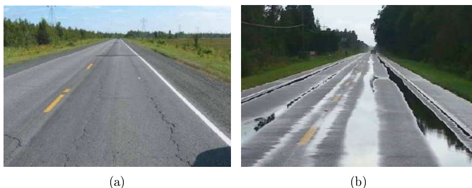
FIGURE 1.3 – Dégradation des chaussées en surface (a) fissuration, (b) orniérage
