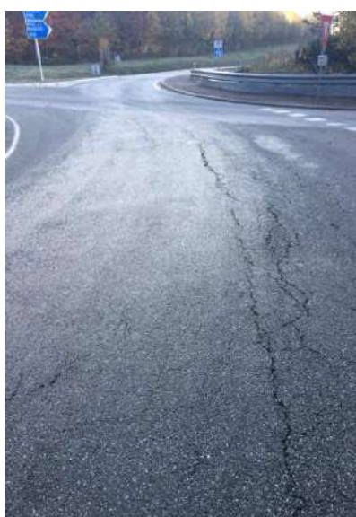
FIGURE 5.14 – Fissuration de chaussée en giratoire
