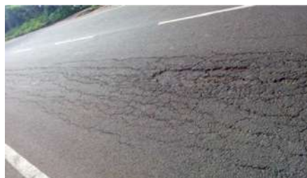
FIGURE 5.6 – Fissuration et arrachement de granulats en surface de chaussée
