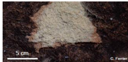
Figure 3.9 – Fine cicatrice d'écaillage survenu au plafond de la carrière.
