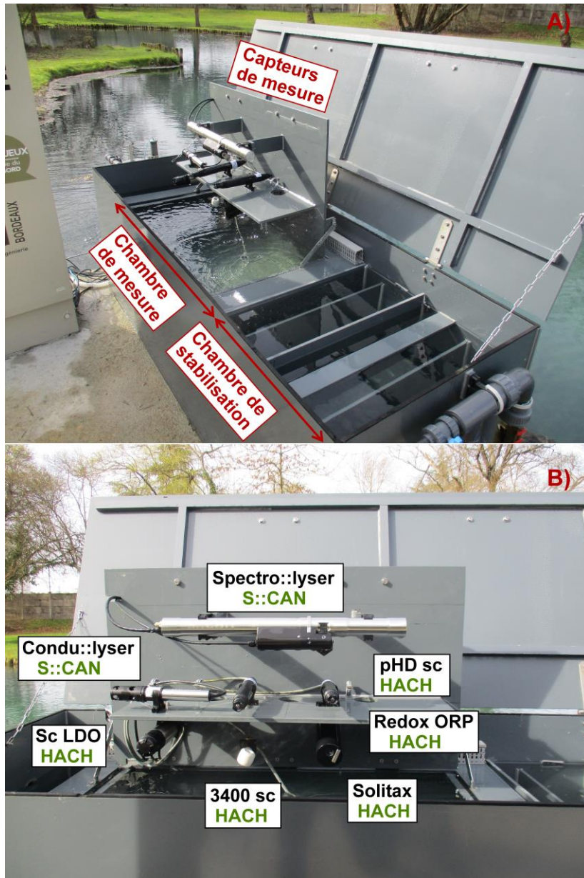
Figure 50 : A) Composition du système de mesure de l'Abîme du Toulon avec illustration de la chambre de stabilisation et de la chambre de mesure. B) Illustration et localisation des capteurs dans la chambre de mesure.
