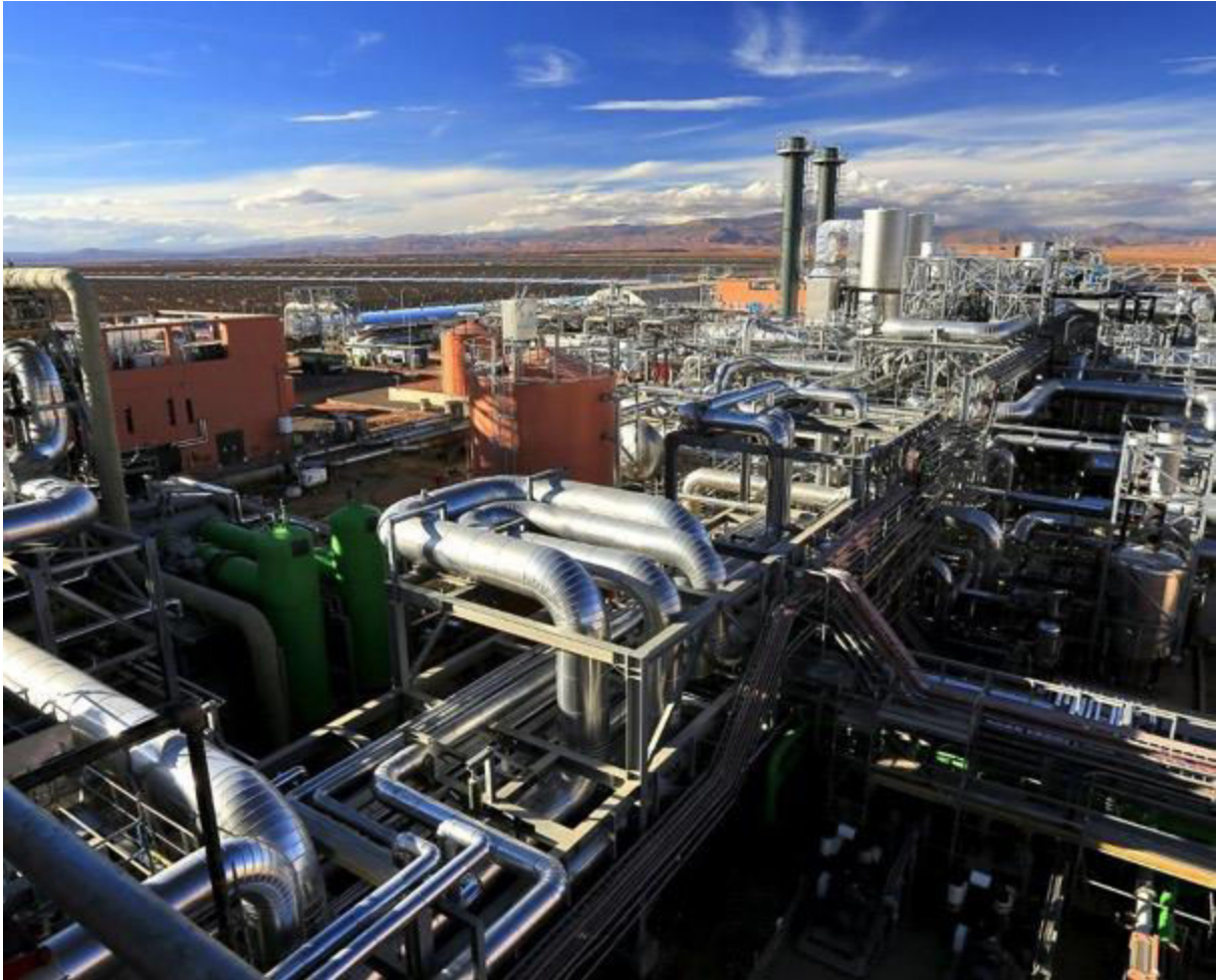
Figure 42 Photographie vue sur la centrale solaire Noo1.
