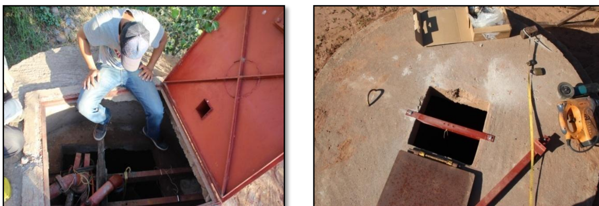
Figure 34 : Installation des Baro et CTD divers au niveau des deux sites du suivi continu P_A et P_B.
