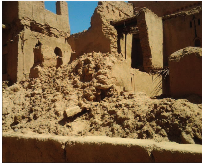
Photo 22- Plafond d'une kasbah très abimé
