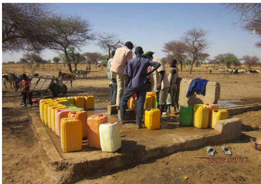
Photo 76 : les murs d'un forage à Kabébangou effondrés et disparus.
