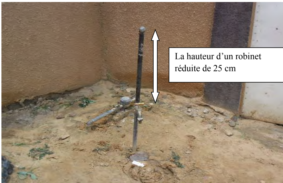
Photo 53 : un exemple de robinet rabaissé au quartier Résidence
