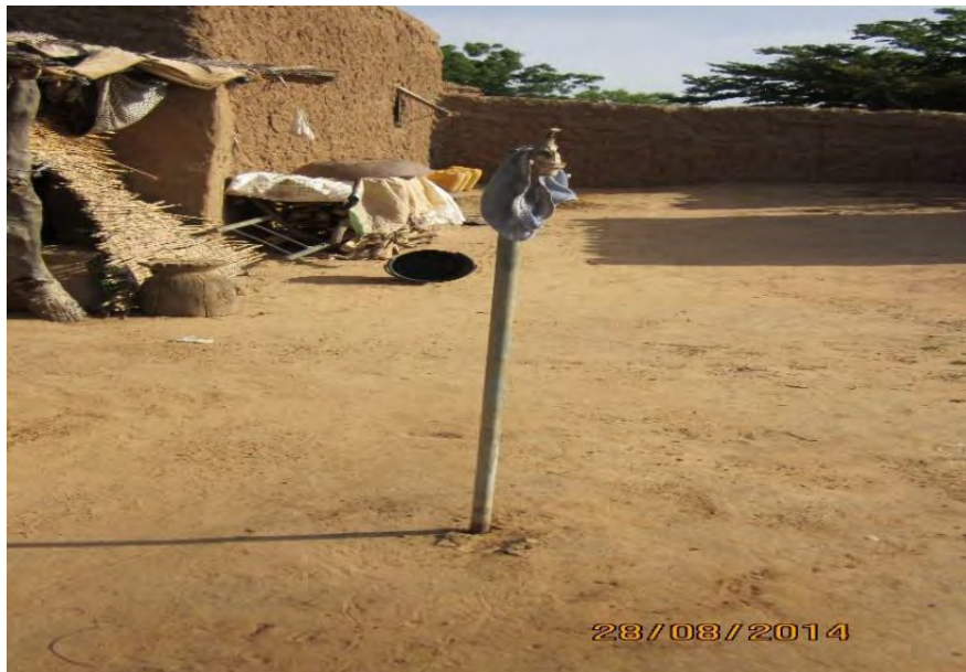
Photo 27 : un exemple de « robinet fantôme » au milieu de la cour d'une concession au quartier Carré
