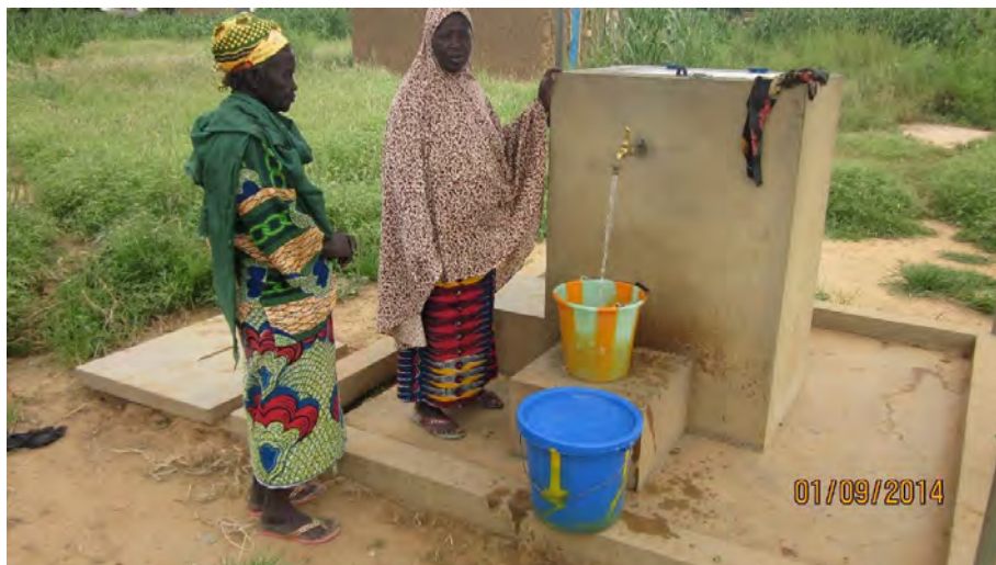
Photo 77 : une borne fontaine à Doumba raccordée au réseau de la MAEP
