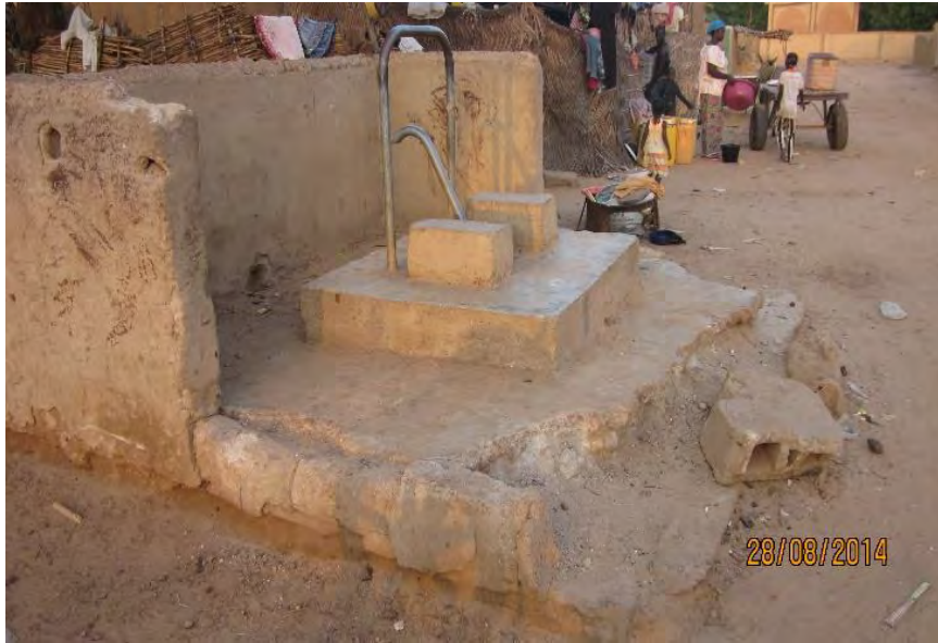
Photo 12 : un forage abandonné dans le quartier Zongo pour forte teneur en nitrate
