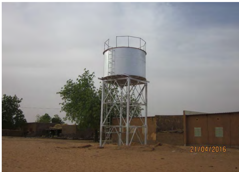
Photo 85 : le poste d'eau autonome de Sirfi Koira avant la fin des travaux : un supplétif à un réseau défaillant
