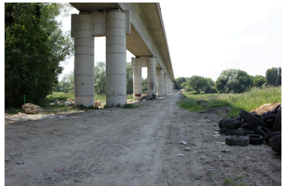
Photographie n°4 : La voie du TGV Nord coupe le vallon du Crould à l'est de Goussainville et contribue à marginaliser cette zone, lieux de pratiques informelles.
