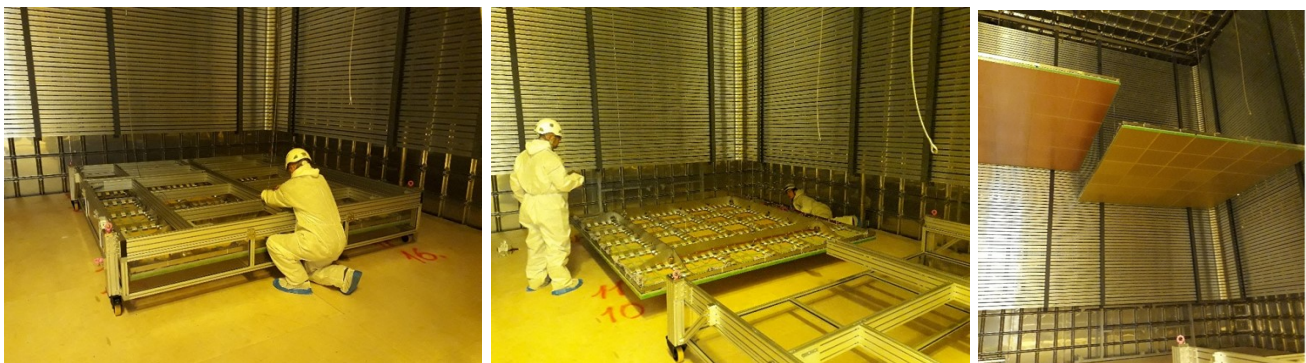
FIGURE 4.21 – Installation de deux CRPs dans le cryostat du 6 \times 6 \times 6 \text{ m}^3 .
