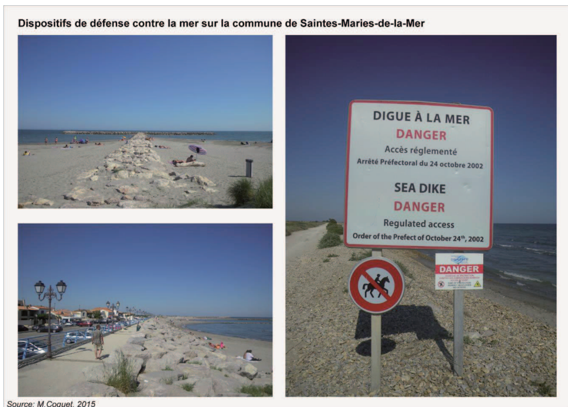
Figure 1.8 : Exemple de dispositifs de défense présents sur la commune des Saintes-Maries-de-la-Mer, en haut à gauche : brise-lame, en bas à gauche : digue avec enrochement, à droite : digue. Source : M. Coquet, 2015.
