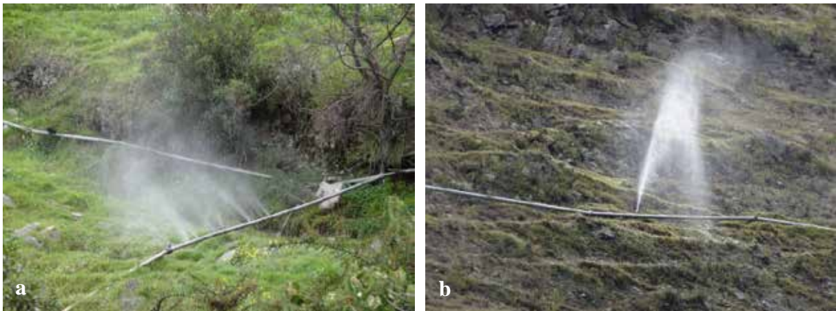
Photo 82 - Fuites d'eau liées à la vétusté des tuyaux. a : Mixteque (septembre 2016); b : Misintá (juillet 2013).
