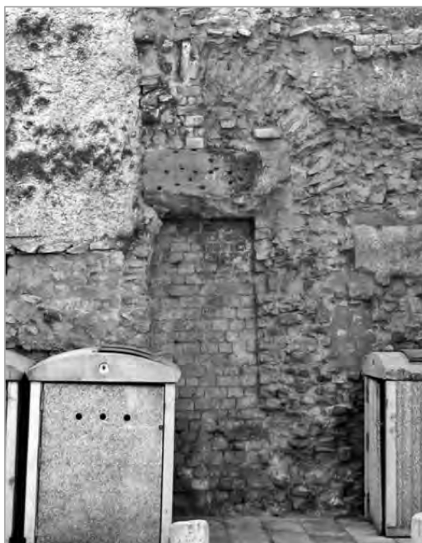
Fig.28 Niche du parement oriental de la paroi occidentale du forum d'Orange (mur de la rue Pontillac), état actuel. Mignon et Paillet 2012, p. 173, fig. 20.
